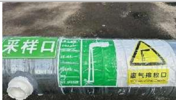
采样口及标识牌
